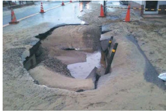
2009.6.21 平安古地区 国道191号漏水現場の様子
