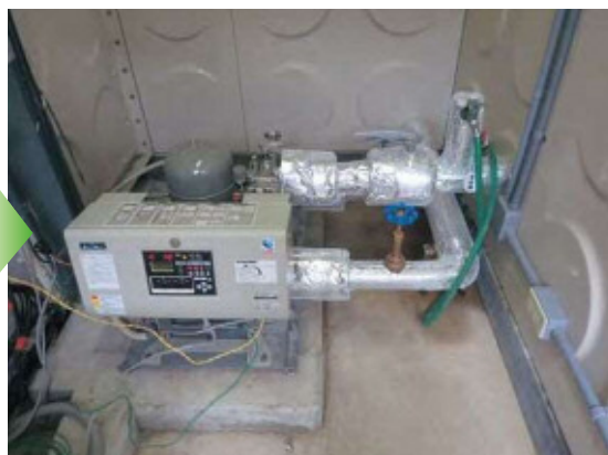
更新後のポンプ設備
