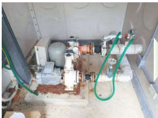
更新前のポンプ設備
