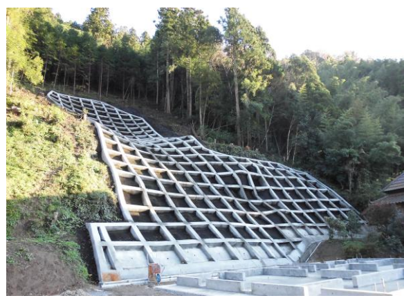
田万川地域（小川5区：がけ崩れ対策）
