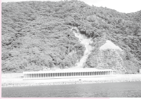
①阿武町木与〜宇田間の法面崩壊
