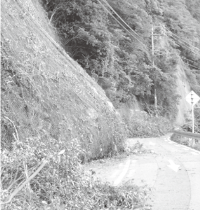
国道262号(川上白馬)の土砂崩れ
