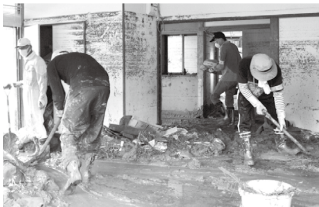
△家屋に入り込んだ泥を除去(小川地区)
