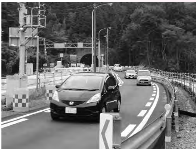
路面崩落により片側交互通行が続く国道191号の須佐トンネル(須佐側)付近
