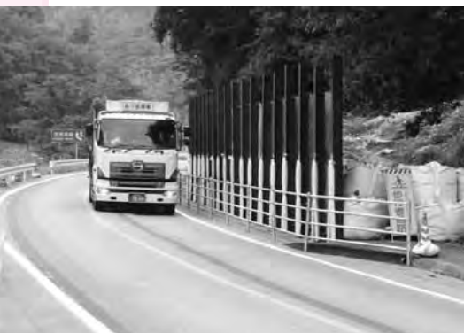
法面崩壊で道路の幅が狭くなった国道191号の須佐トンネル～大刈トンネル間
