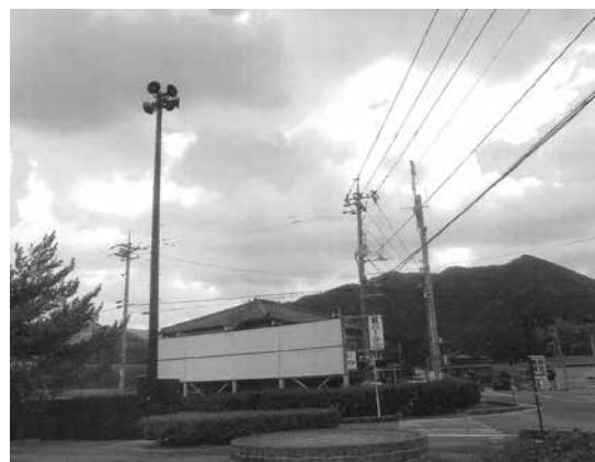
整備予定の防災行政無線機器
