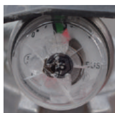
× 指示圧力計の損傷
