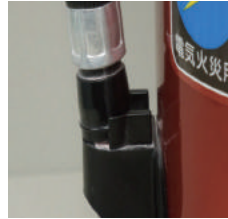
× 消火薬剤の漏れ
