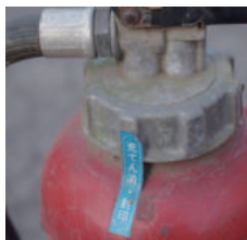
× キャップの劣化
