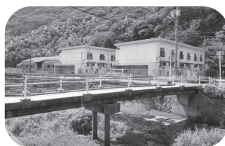
拡幅が望まれる「玉江沖田橋」
