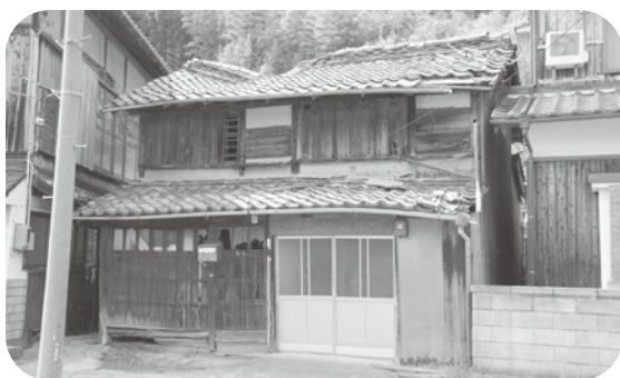
老朽した空き家
