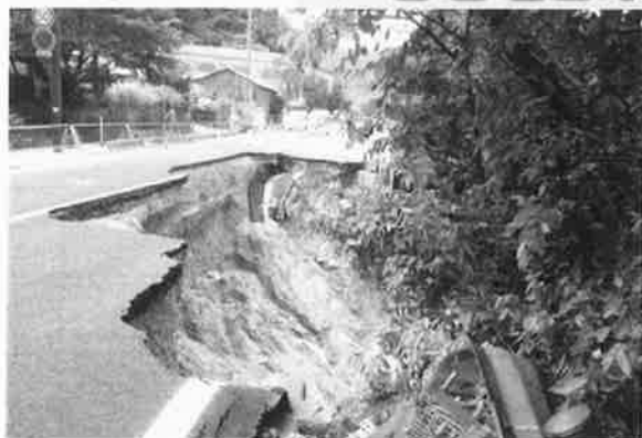
県道萩篠生線(椿東中ノ倉)の道台崩落
