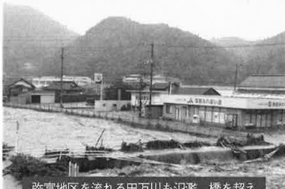
弥富地区を流れる田万川も氾濫。橋を超えて流れた濁流により欄干も壊れた(正午頃)
