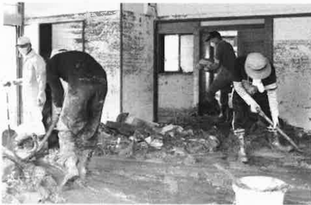
△家屋に入り込んだ泥を除去(小川地区)
