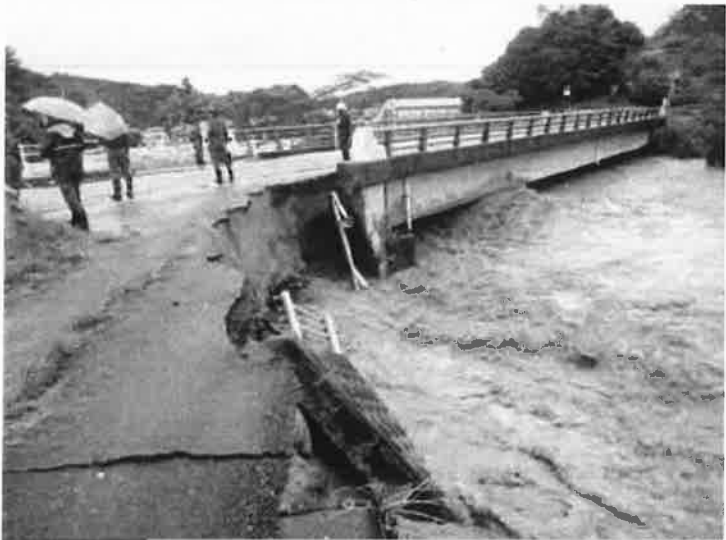
大光寺橋 (28日) 午前10時前の吉部下の志和田交差点付近。蔵目喜川の氾濫により、大光寺橋の一部が崩壊した。
