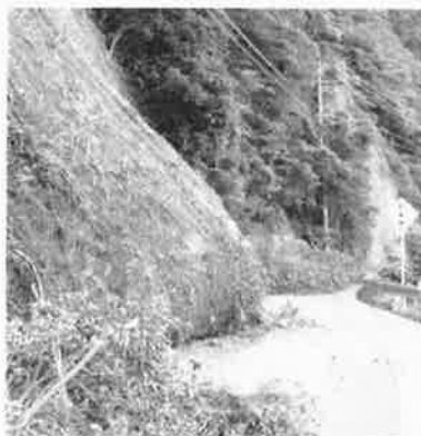
国道262号(川上白馬)の土砂崩れ
