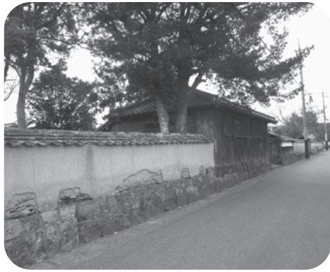
堀内伝建地区内の道路にはみ出す樹木と剥がれた白壁
