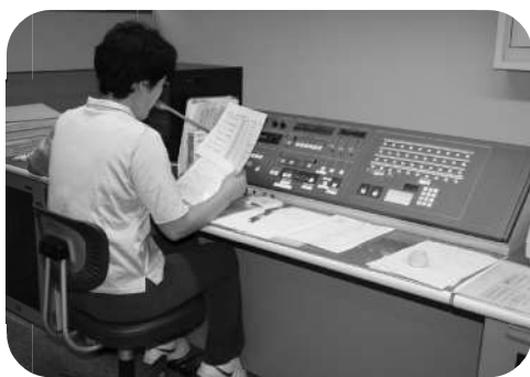
防災行政無線室
