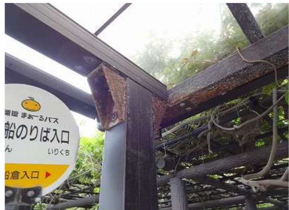
【上屋の劣化状況】
