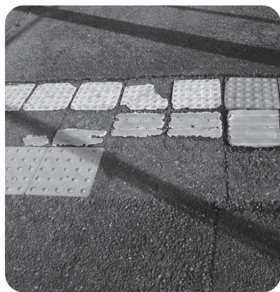
劣化した点字ブロック
