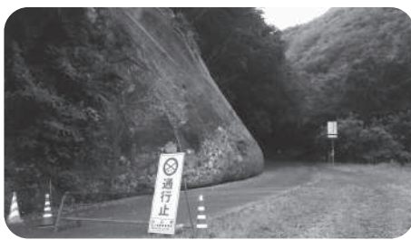
県道津和野須佐線の土砂崩れ(鈴野川地区)
