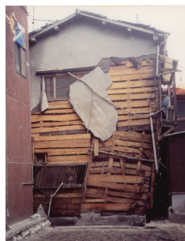
阪神・淡路大震災で被害にあった住宅
