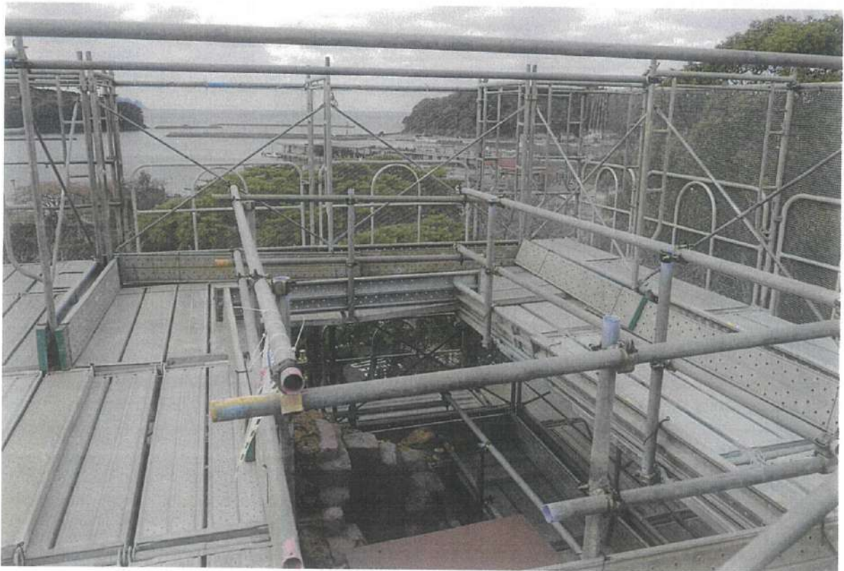
写真4 足場最上段7段目（地上約10.1m）からの風景（恵美須ヶ鼻造船所跡方向）
