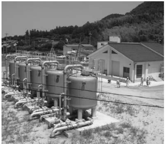
上津江浄水場 除マンガン装置
