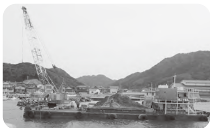
漁港内の土砂堆積の様子
