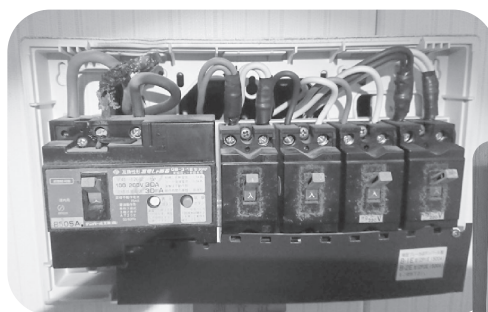
↑分電盤（事故時）
