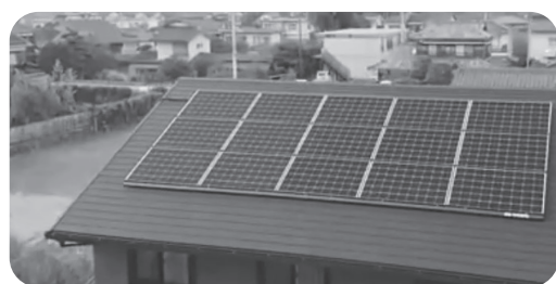
太陽光発電設備
