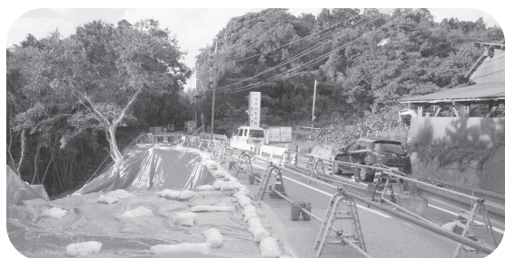
片側通行となった県道萩篠生線
