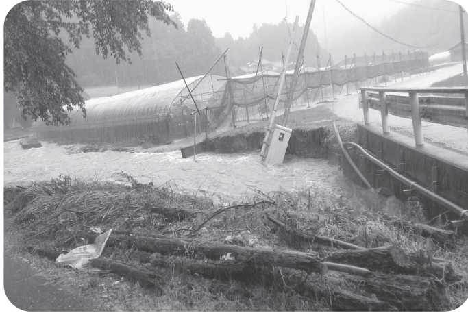
被災したマンホール制御盤
