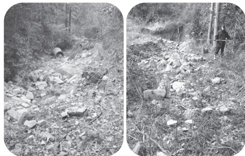
災害復旧の対象になっていない林道の様子
