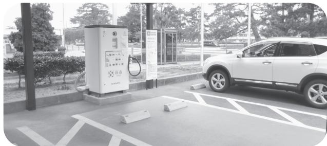
市役所前の急速充電器
