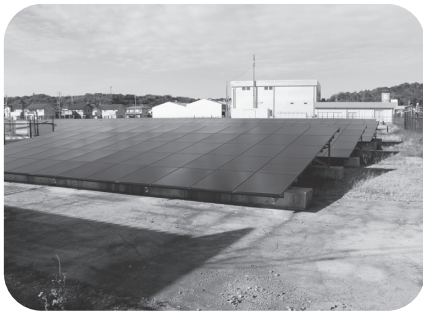
再生エネ施設
