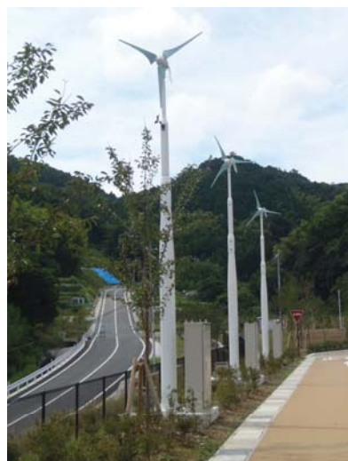
■風力発電設備
