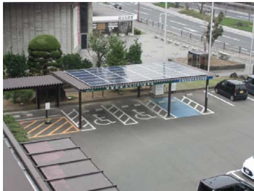
■市役所前庭おもいやり駐車場屋根
