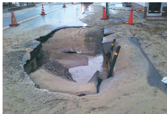
2009.6.21 平安古地区 国道191号漏水現場の様子
