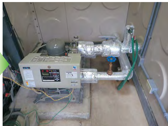
更新後のポンプ設備
