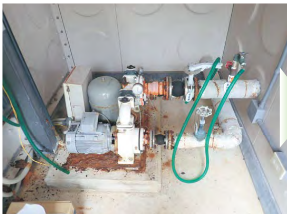
更新前のポンプ設備
