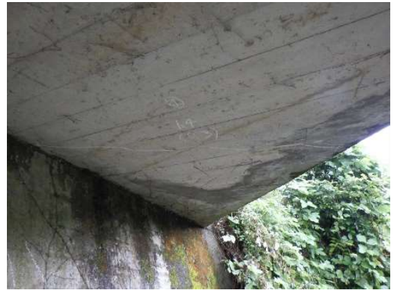
コンクリート橋 ひびわれ
