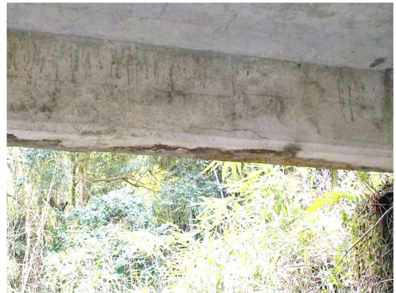
コンクリート橋 うき、剥離・鉄筋露出
