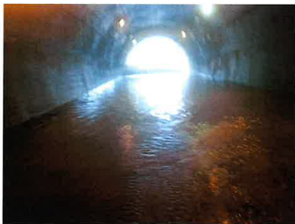
金山谷トンネル内は湖状態
