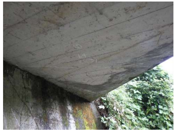
コンクリート橋 ひびわれ
