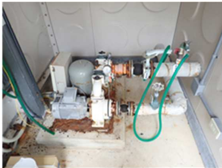
更新前のポンプ設備
