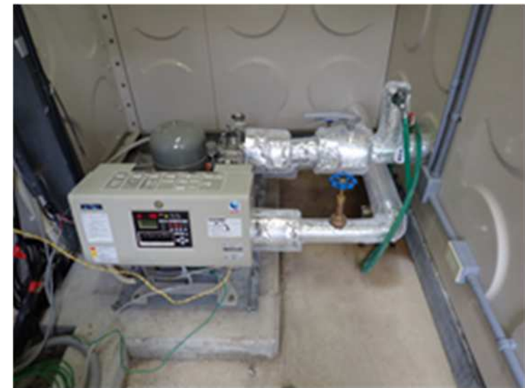
更新後のポンプ設備
